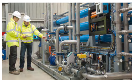
Viledon-Aquabio-Filteranlage von Freudenberg Filtration Technologies, 2014
